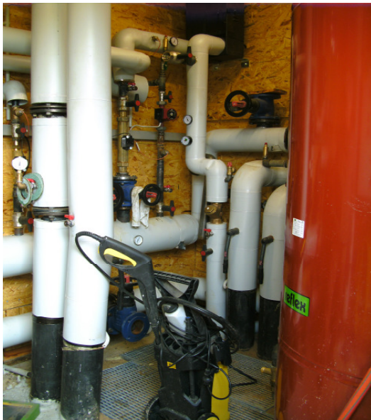
(Foto: Herz eines BHKWs)
